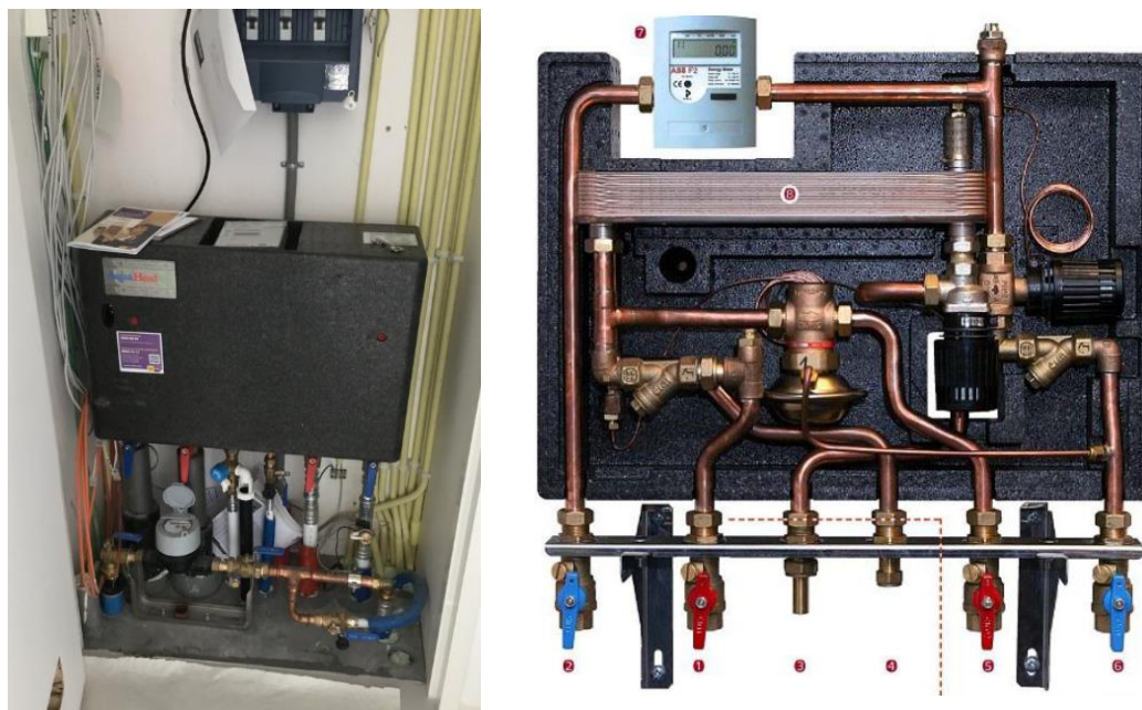
Figuur 42: Afleverset geplaatst in de meterkast (links) en open (rechts).
